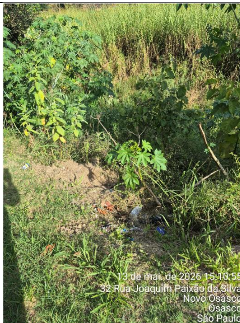
Imagem 41 – Princípio de erosão que exige análise mais profunda para identificação da causa. Área com lixo acumulado.
