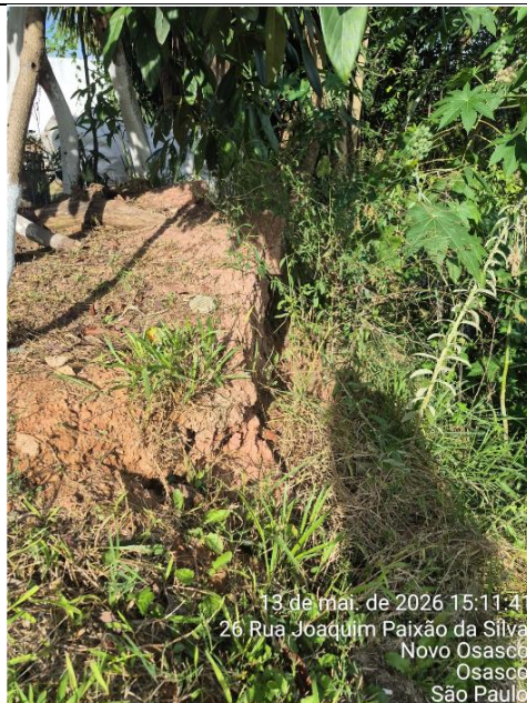
Imagem 42 – Princípio de erosão que exige análise mais profunda para identificação da causa
