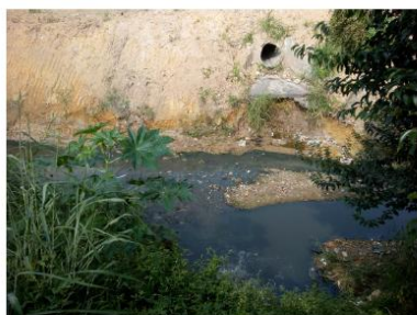
Fotografia 03 – Vista para o córrego totalmente poluído.
